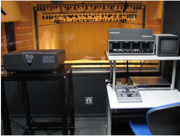
調整室内設置状況
